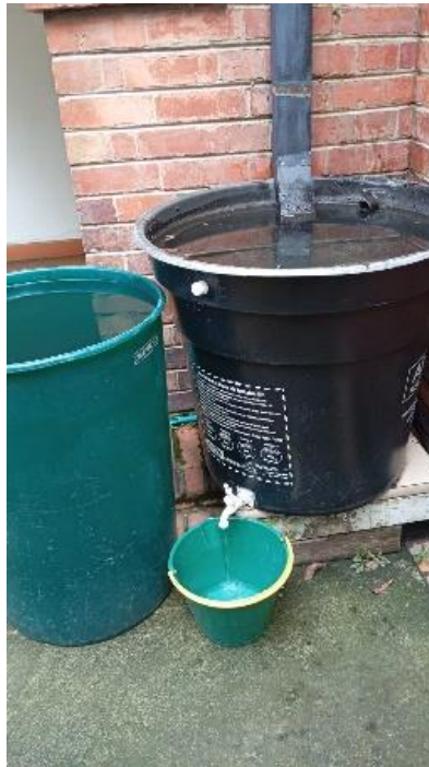
Figura 7: Fotografía del sistema de recolección de aguas lluvias, instalado en la Sede principal de la Alcaldía Local de Barrios Unidos.
